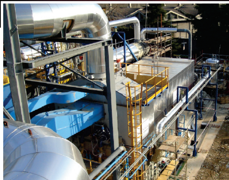
Kocioł wodnorurkowy na parę przegrzaną, typ CTH (40 MW), do wytwarzania energii dla miasta Brescia (Włochy).
